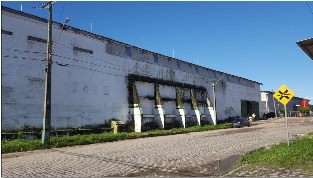
Figura 69: Ausência de Calçadas presente junto às colunas.
